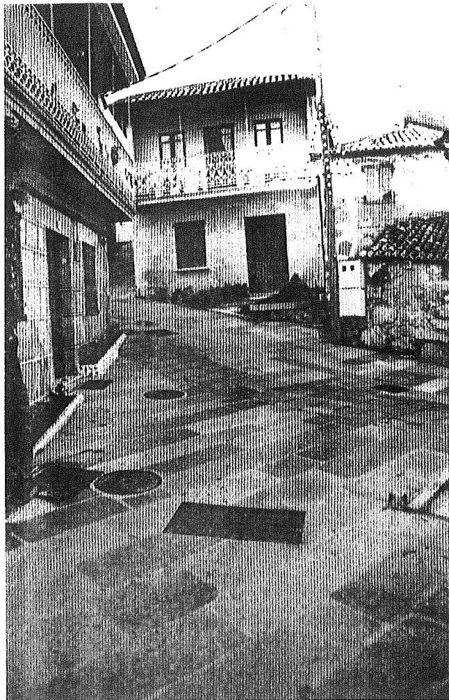
Foto 16. Pavimento restaurado: excesivamente liso, demasiadas tapas e rexistros, deficiente recollida de pluviais
